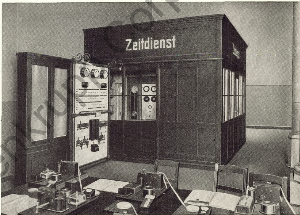
Abb. 7. Zentralraum der Zeitdienstanlagen im Telegraphenzimmer des Schlesischen Bahnhofs in Berlin
