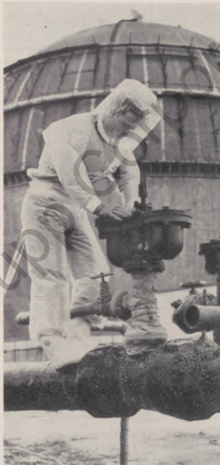
Ein Ausschnitt aus Englands neuestem und modernstem Atomkraftwerk in Downreay. Ein wesentlicher Teil dieses Werkes ist ein riesiger Stahlglobus, in dem sich ein Beschleunigungsreaktor befindet. Unser Bild: Im Schutzanzug prüft ein Techniker die Ventile
