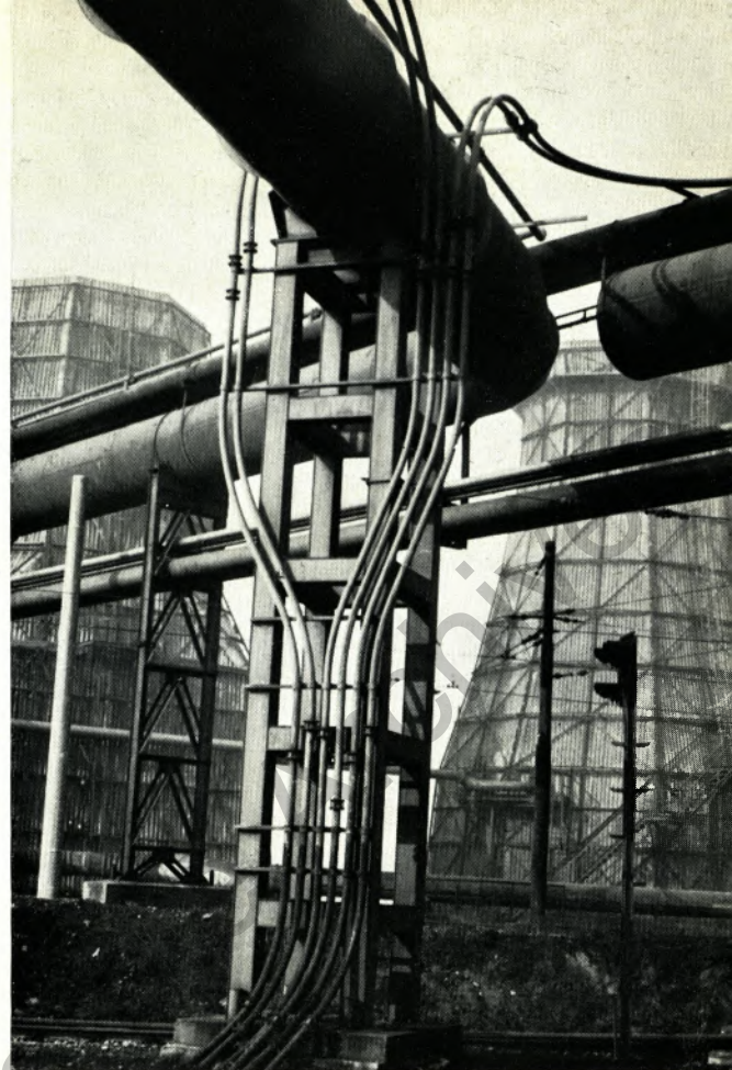
Treffpunkt aller Rohrpost-Fahrleitungen in unmittelbarer Nähe der Maschinenstation „Schacht 4/8“.
