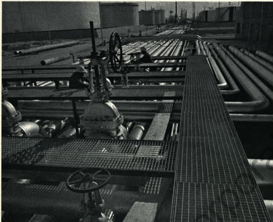
Rohrtrasse und Verteilerstück am sogenannten „White-Oil“-Pumpenhaus.
