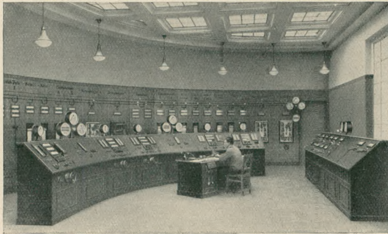
Abb. 7. Schaltbühne eines Großkraftwerkes (Zum Aufsatz auf Seite 97 bis 100)
