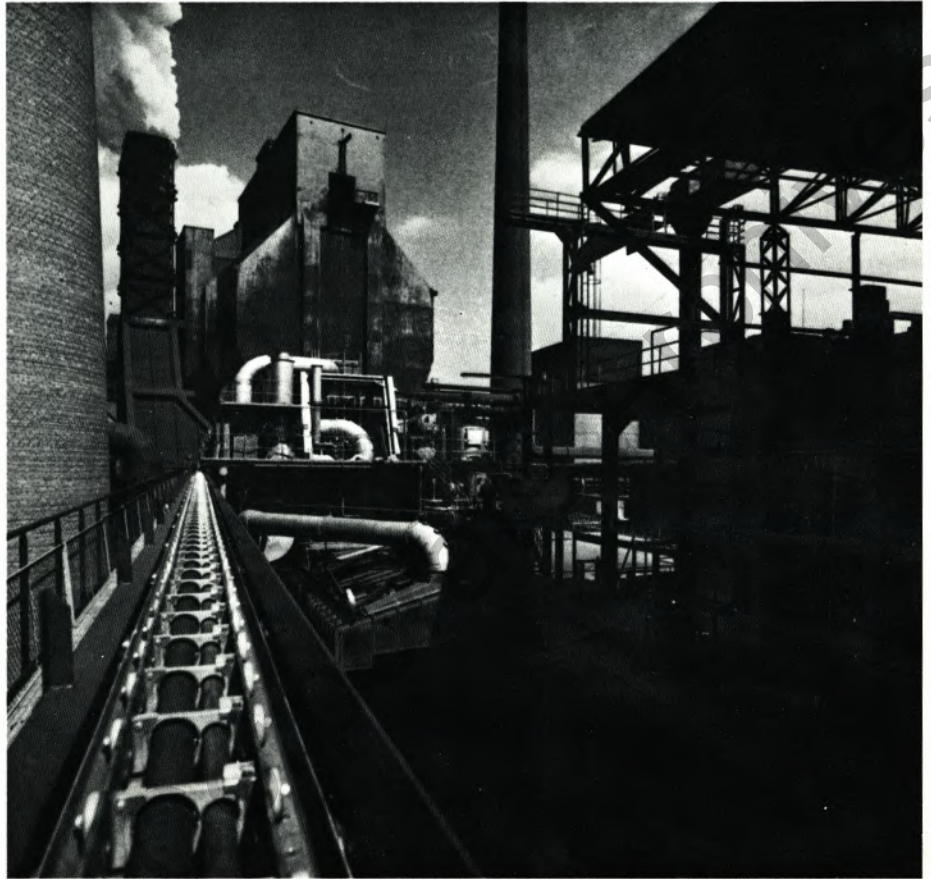
Mit der in der Bildmitte erkennbaren neuen Abzugshaube saugt man auf der Kokerei ATH nun beim Drückvorgang entstehendes Gas und Staub ab.
