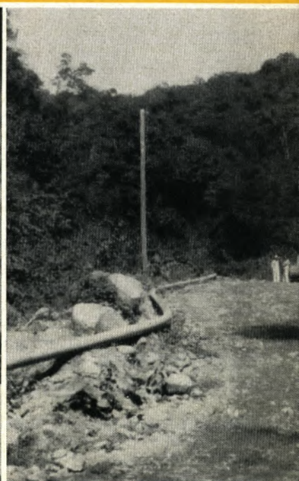
Von den Bohrplätzen ziehen sich lange Ölleitungen ins Land. Das Foto führt uns nach Bolivien. Entlang der einzigen Straße durch den Urwald verläuft der Rohrstrang
