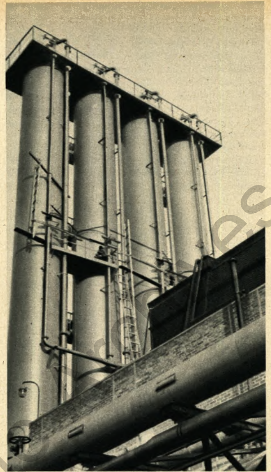
Teilansicht der Pottaschanlage zur Entfernung der Kohlensäure aus dem Gas. Unser Bild zeigt die Waschtürme, vor denen (im Bild nicht sichtbar) die Türme der Langenregeneration liegen.
