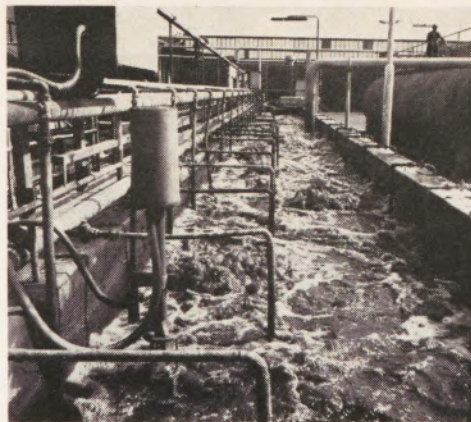
Bild 5: Neutralisationsrinne mit Stapelanlage
