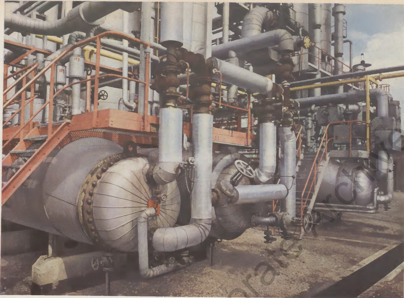
Abb. 1 Abhitzekessel der Farbwerke Hoechst im Werk Genndorf
