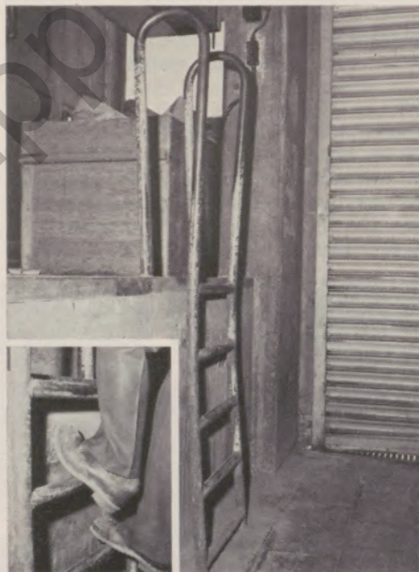
Diese Steigleiter wurde so weit eingedrückt, daß die Trittsicherheit auf den Holmen nicht mehr gewährleistet ist. Derartige Defekte bitte sofort dem Vorgesetzten melden.
