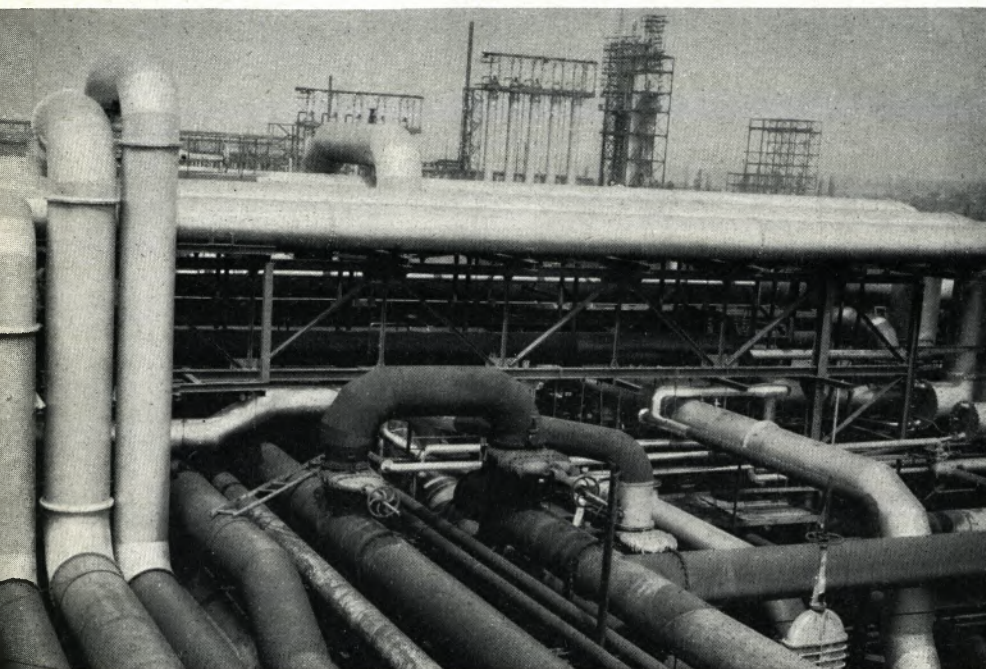
Ein verwirrendes System von Rohrschlangen kennzeichnet moderne chemische Fabriken. Blick auf eine Kontaktwasserstofffabrik der BASF in Ludwigshafen. Ein erheblicher Teil dieser Rohre wurde von uns geliefert
