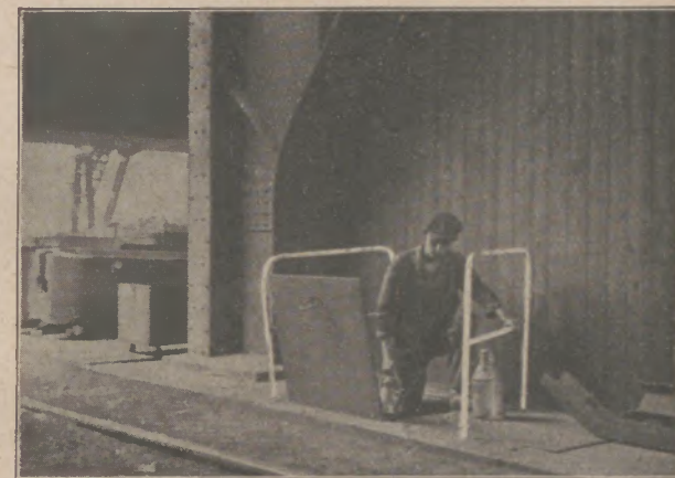
Bild 5: Der Mann entfernt beim Heraussteigen das Geländer
