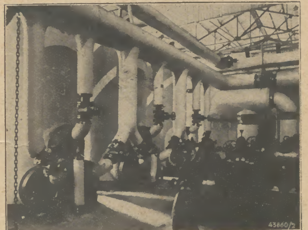
Abb. 4: Blick in die Fernheizzentrale. (Die Wärmeaustauscher — im ganzen neun — sind gleichzeitig Warmwasserspeicher.)
