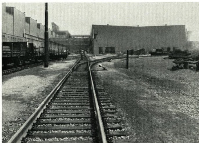
Die Zufahrt zur Flammerei Beckerwerth. Hier wurden schwere Schienen der Form UIC 60 verwendet.
