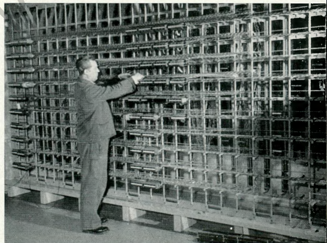
Bild 1 Kabelverteiler in der Postnebenstellen-Zentrale des Werkes Hörde
