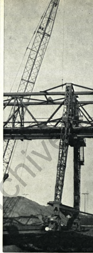
Die landseitige Brückenstütze ebenfalls verzogen
