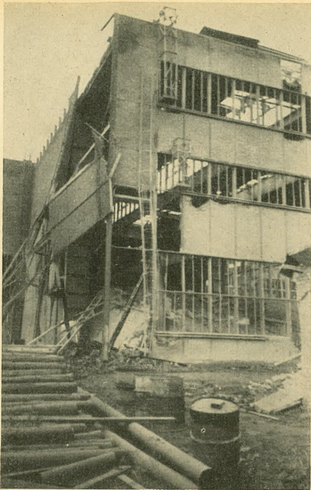
Werkstatt und Klinkerhalle nach der Zerstörung
