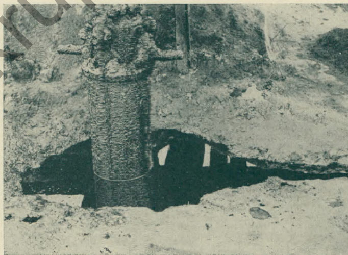
Das mit Öl beschlagene Oberteil einer Pumpe. Das Öl ist bis an die Oberfläche des Bohrloches getreten.
