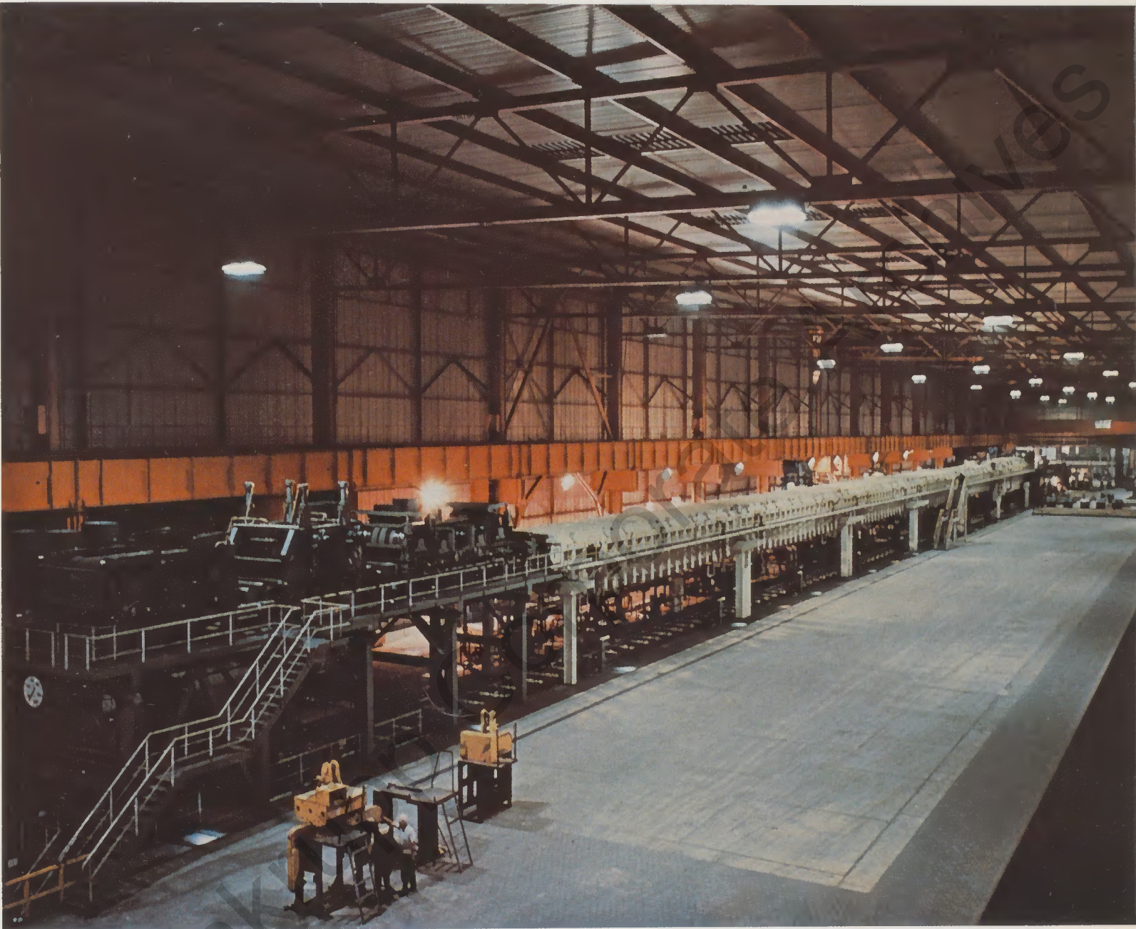
Kontinuierliche Hochleistungs-Bandbeizanlage Krupp Hüttenwerke
