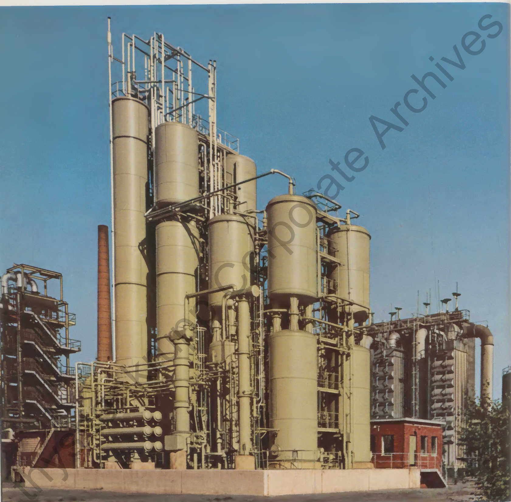
Entphenolungsanlage für Ammoniakwasser, Buer-Hassel
