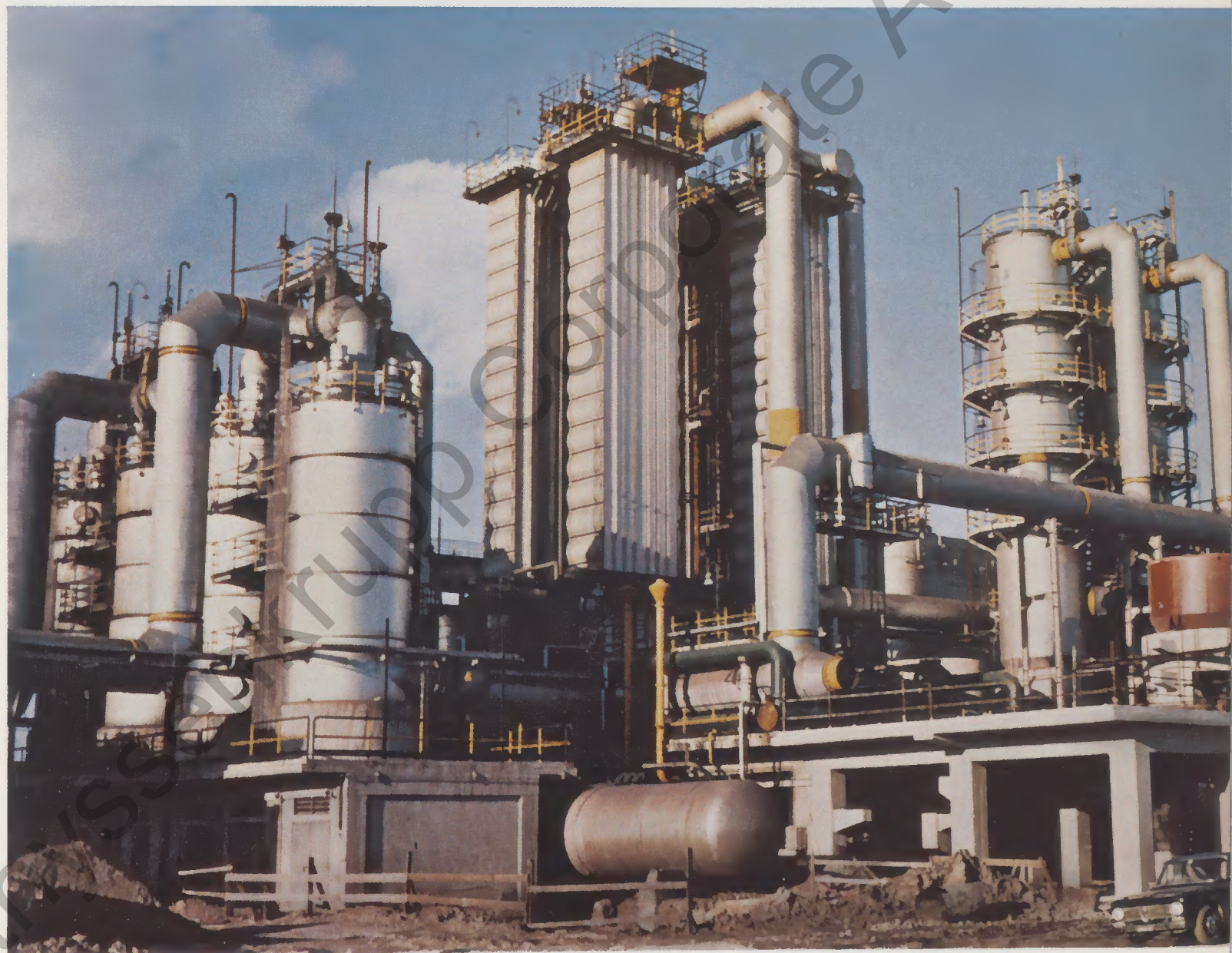
Kühleinrichtung und Wascher der Kohlenwertstoffanlage Taranto (Italien)
