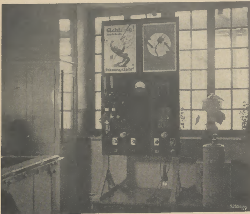
Schalttafel mit Automat für Selbstauschaltung bei Überlastung der Anlage
