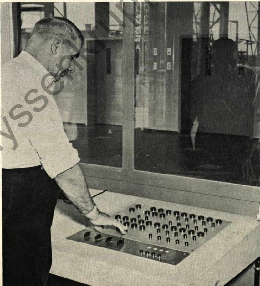
Von dieser zentralen Schalttafel aus bedient der Waschkauenwärter Hermann Gibkes die Beleuchtung sowie die Be- und Entlüftung des modernen Mülheimer Waschkauenhochhauses
