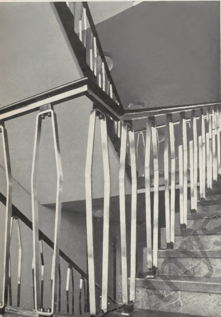
Treppengeländer aus REMANIT im Gebäude unserer Hauptverwaltung
