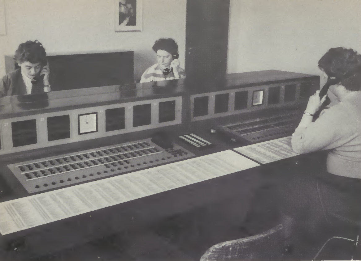
Fernsprechzentrale erhielt moderne Edelmetal-Motor- Drehwähler-Anlage
