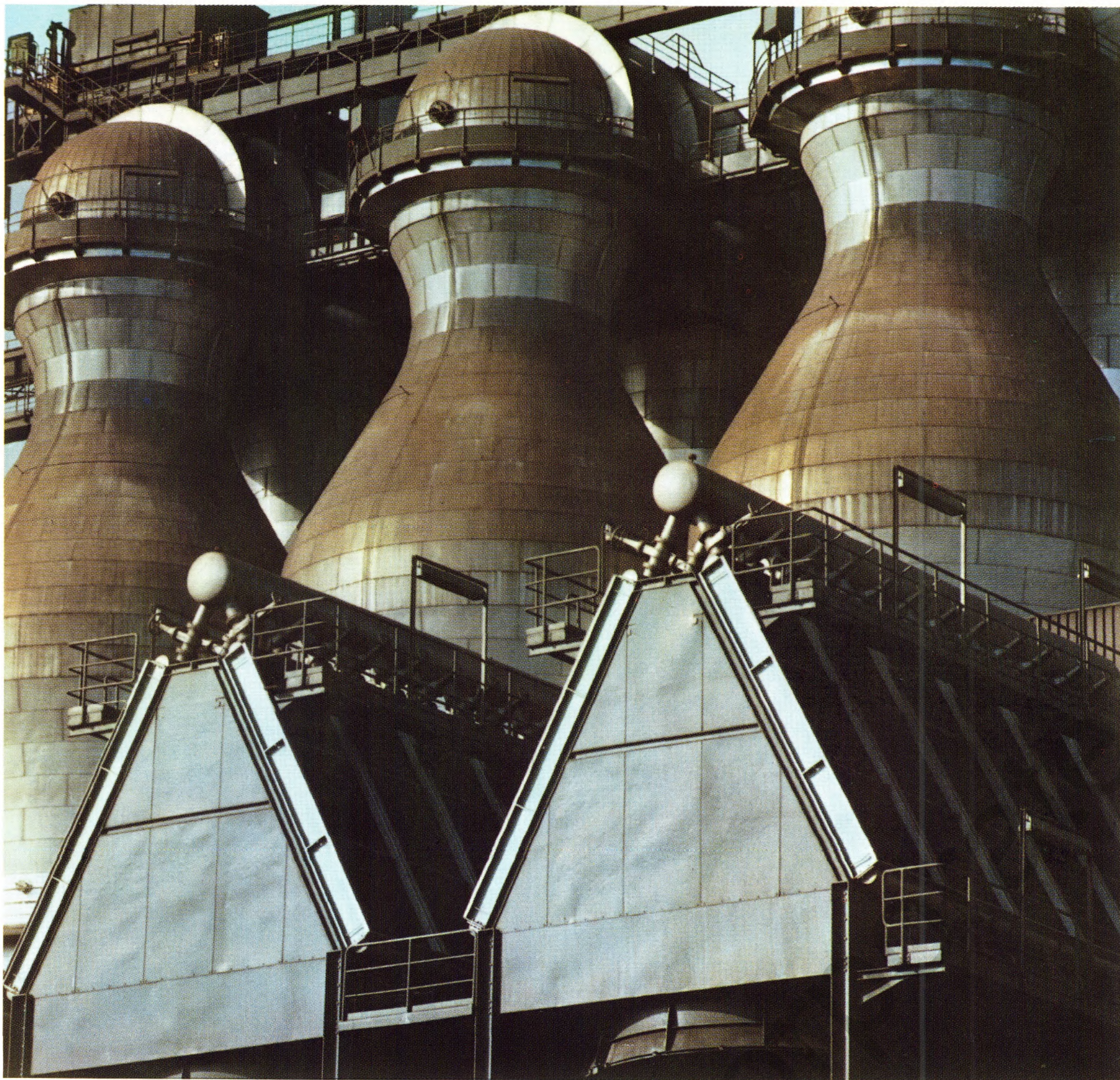
DAS BILD ZEIGT die Winderhitzer-Gruppe des neuen Hochofens Schwelgern
