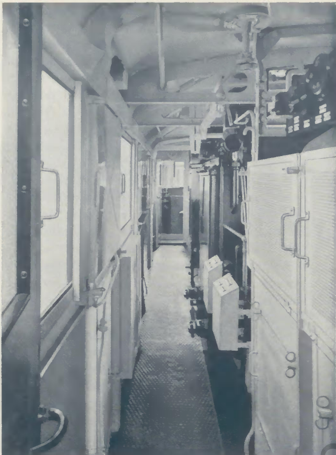
LAUFGANG IM MASCHINENRAUM
