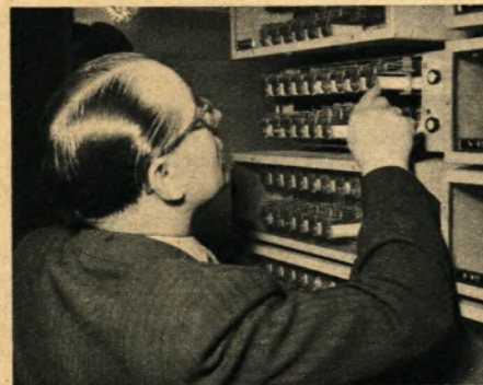
Das Herz der Anlage: Hans Oebel im Relaisraum der neuen elektrischen Stellanlage des Stellwerkes „Mischer“, über das wir auf Seite 106 berichten
