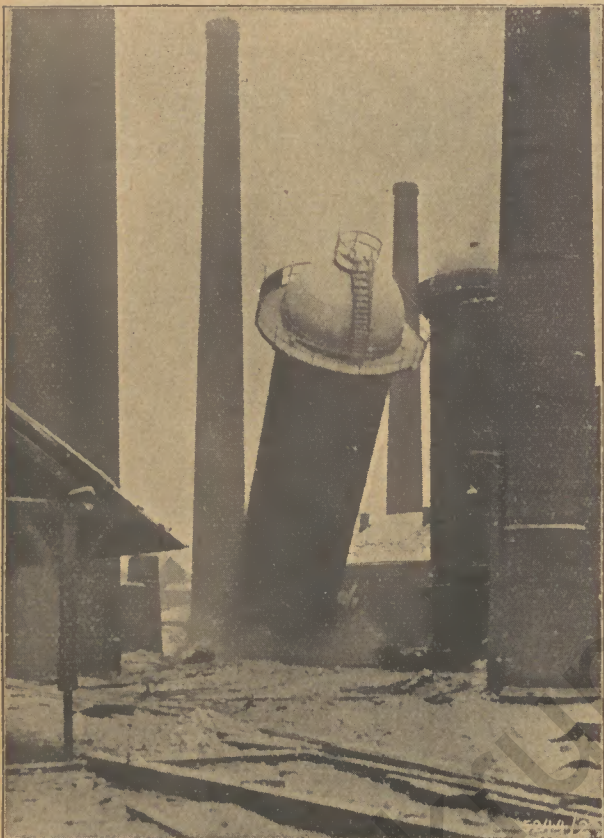
Gesprengter Cowper im Sturz
