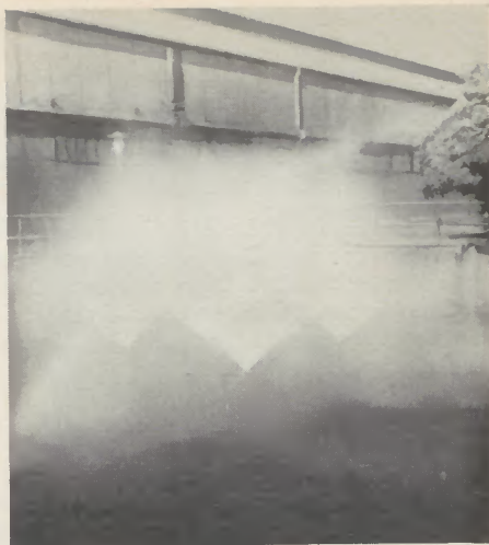
Das nach Verlassen der Kompressoren stark erwärmte Kühlwasser wird durch offene Verdüsung über einem ehemaligen Löschteich abgekühlt.
