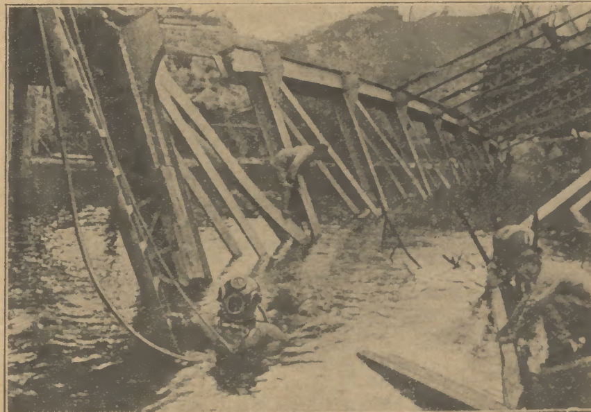
Eisenteile einer eingestürzten Brücke, die mit Hilfe des Unterwasserschneidbrenners beseitigt werden müssen.
