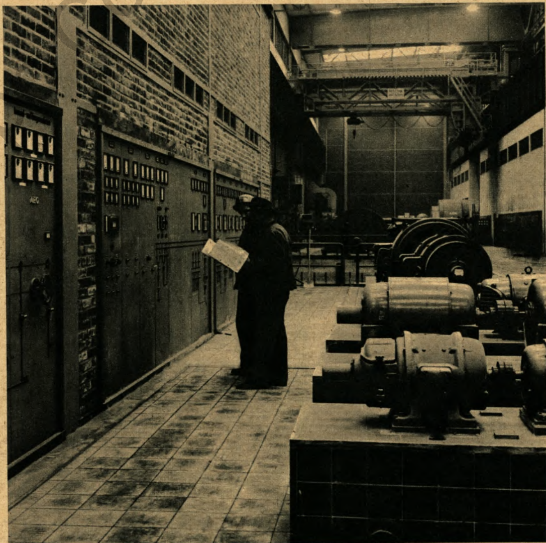
► Im Mai dieses Jahres konnte die neuerbaute Breitbandstraße auf der Hoesch-Westfalenhütte den Probetrieb aufnehmen. Unser Bild zeigt einen Blick in das Maschinenhaus
