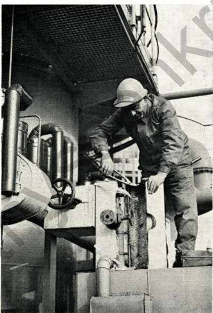
Rückseite: Zwei Drittel aller Rohrleitungen der Chemischen Werke Hüls sind gegen Wärmeverluste isoliert. Ihre wärmehaltende Hülle ist von Platal umschlossen, das gegen Witterungseinflüsse, chemische Dämpfe und mechanische Beschädigungen schützt
