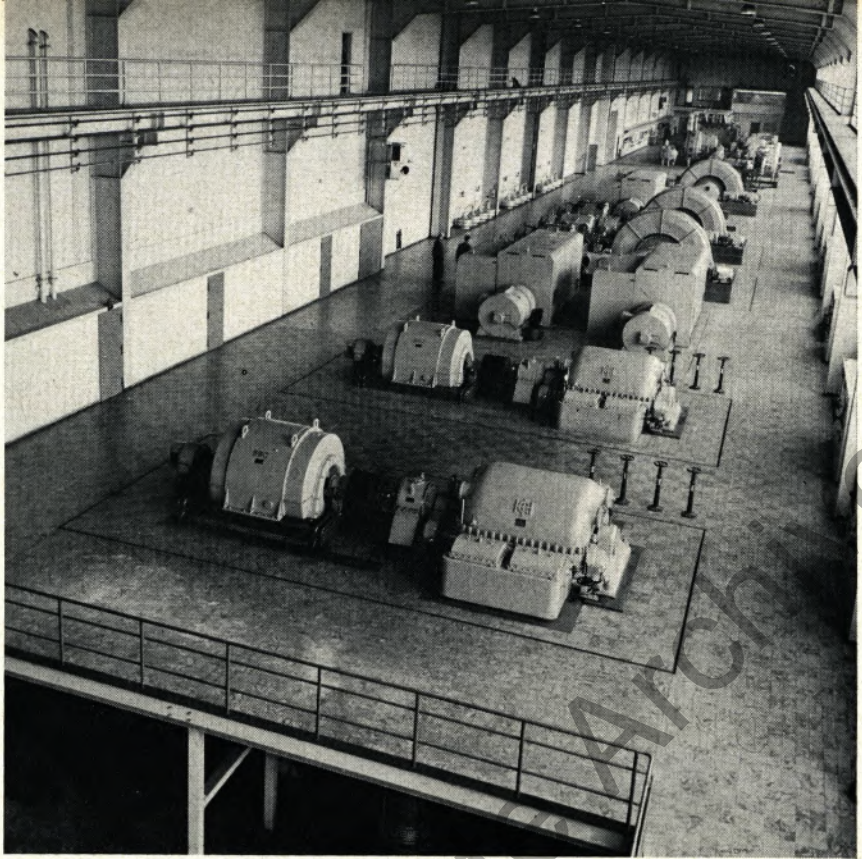
Blick in die Maschinenhalle der Ruhrorter Sauerstoffanlage mit den Turboluftverdichtern im Vordergrund. Dahinter befinden sich die Stickstoff-Hochdruckverdichter bis 100 bzw. 200 atü.
