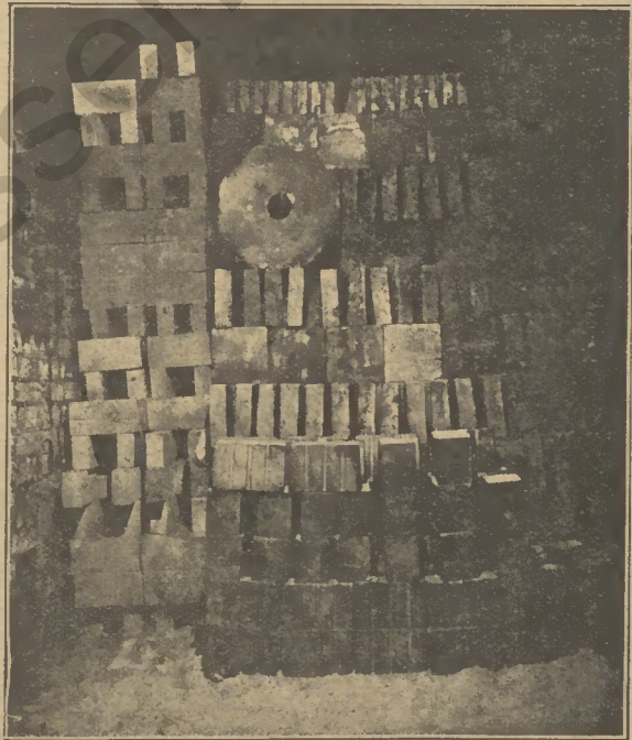
Steine in der Brennkammer eines Mendheim'schen Gasofens.
