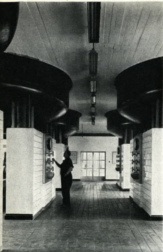
Ein Blick in die Filteranlage in unserem Werk Poensgen
