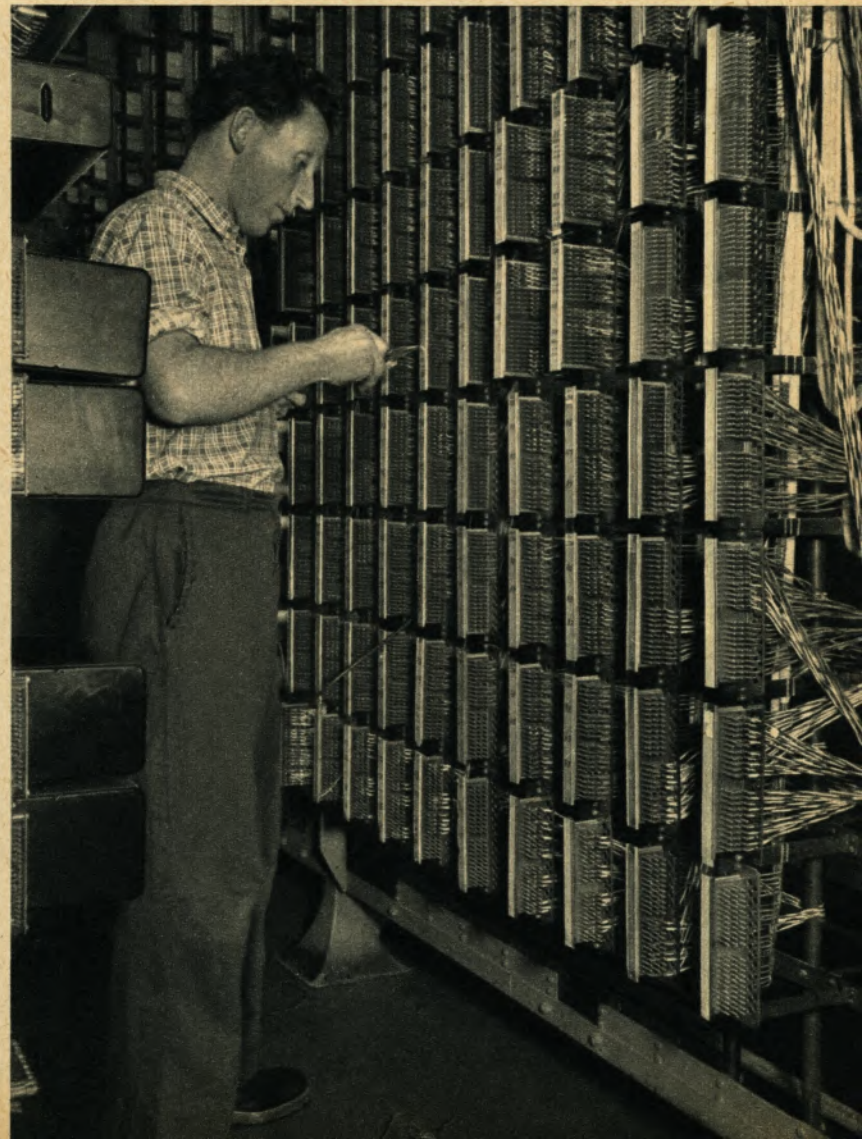
Bild unten: Josef Helbing beim Lötén im Hauptverteiler. Hier laufen alle Strippen zusammen
