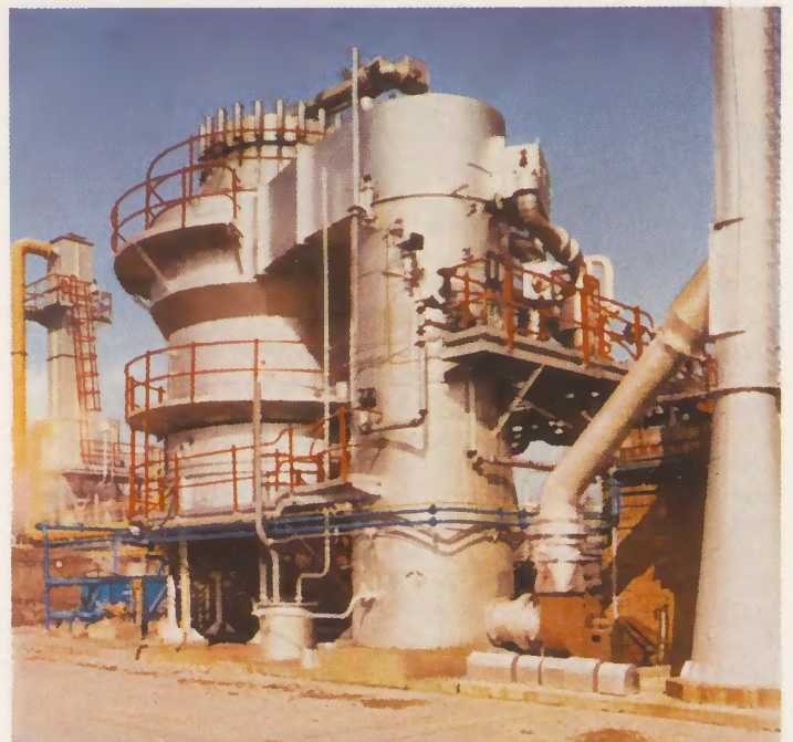
Otto-Spaltvergasungsanlage für Stadtgas 1962
