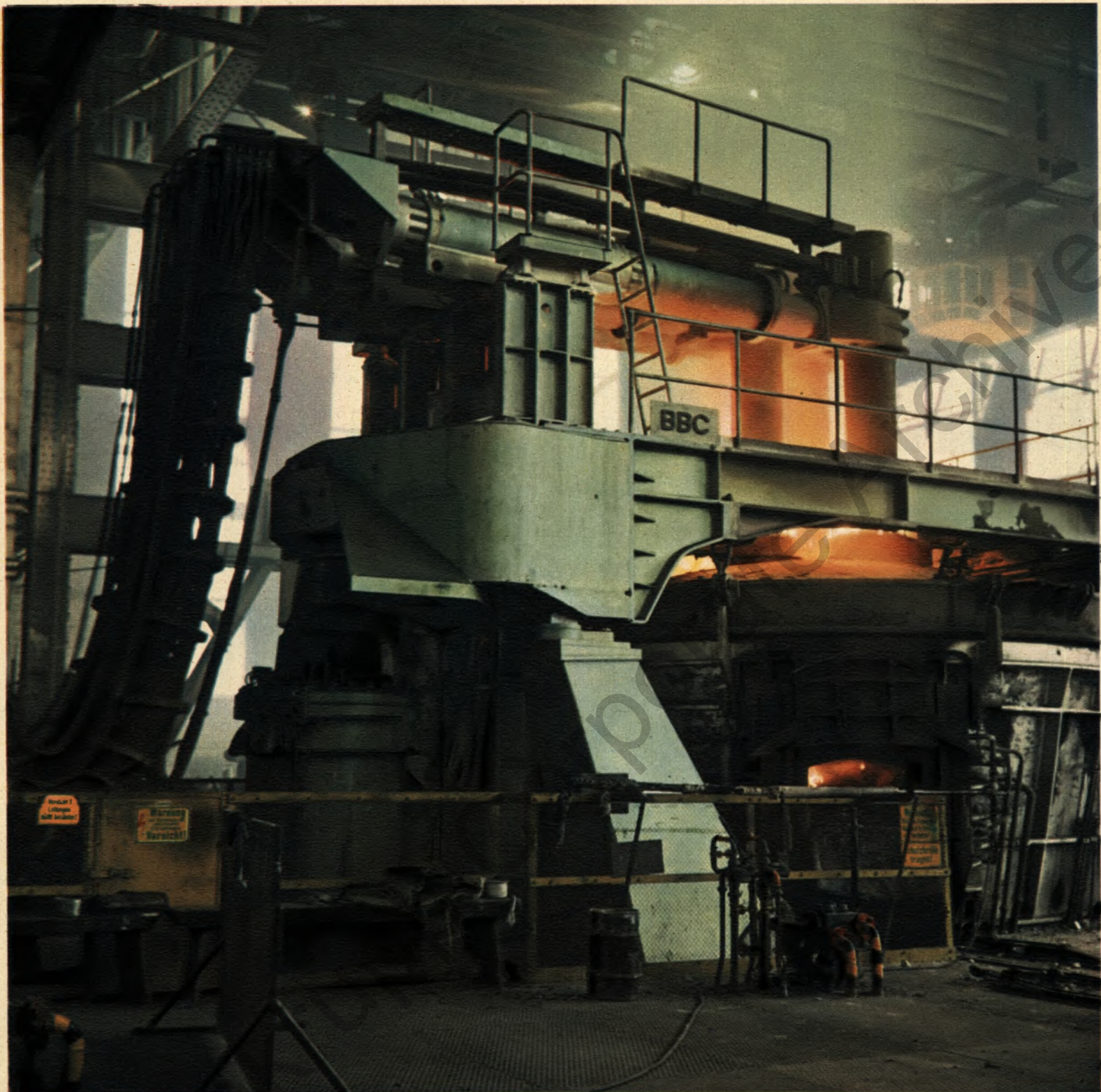
Eine Gesamtansicht des neuen Elektroofens
