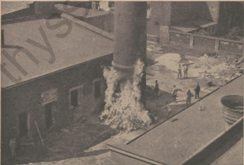
— — und schon nagt das Feuer an der Stütze
