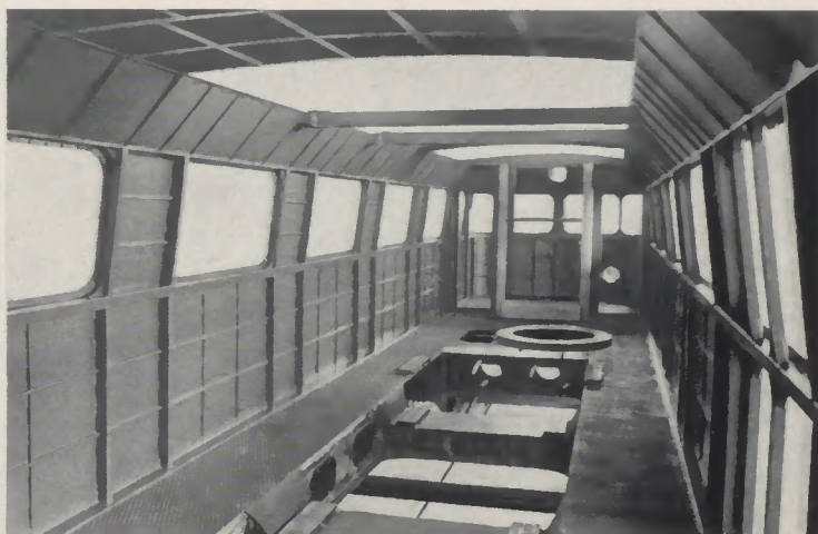
▼ Bild 10. Blick in den Kastenbau einer diesel-elektrischen Lokomotive.
