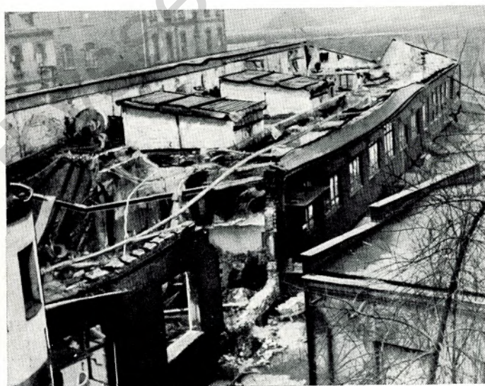
Trümmerreste des 1938 erbauten Laboratoriums der Hütte
