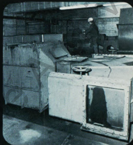
Zur Lärmdämmung sind Ventilatoren in dickwandigen Betonkellern aufgestellt. Das Foto zeigt einen Abluftschalldämpfer der neuen Entstaubungsanlage für 80.000 m 3 Luft/Stunde.
