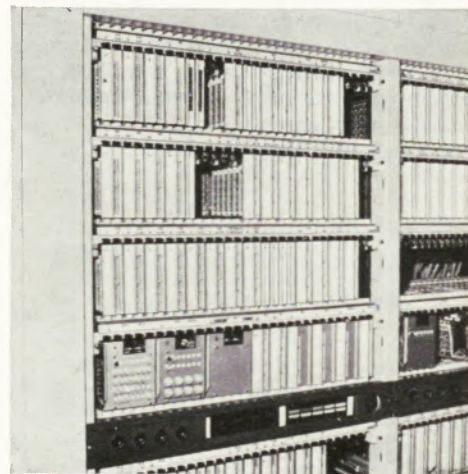
Zentrale Steuerung für 1000 Anschluß-Einheiten
