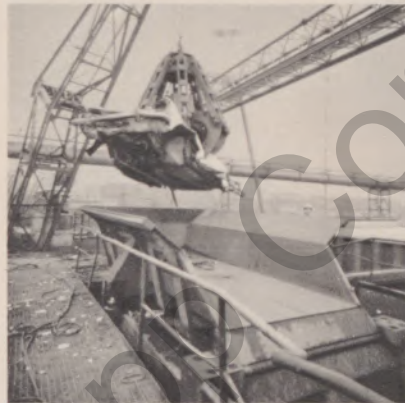
▲ In dieser Schrottpresse auf dem Gelände Stockheide wird der Schrott zu Paketen gepreßt
