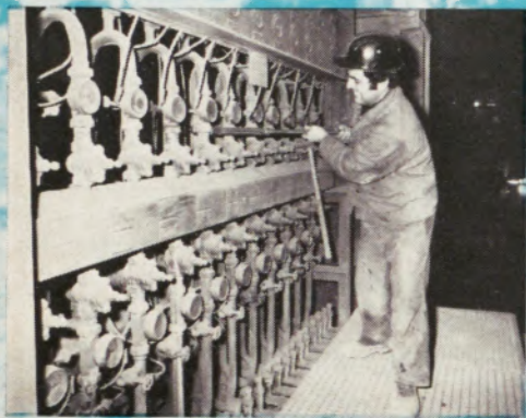
Bild 5 Unser Mitarbeiter Manfred Düster bei der Kontrolle am Wasserverteilerschrank
