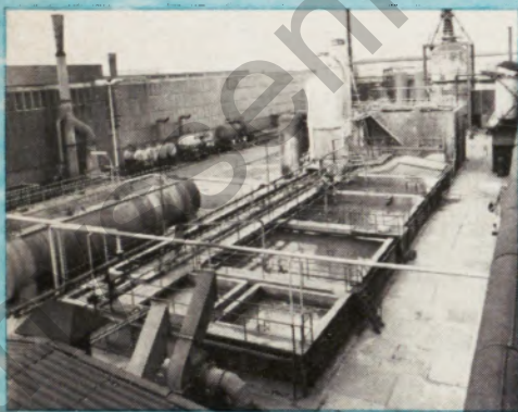
Bild 6 Neutralisationsanlage für Altsäuren, Laugen und saure Spülwasser im Innenhof des Kaltbandwerkes
