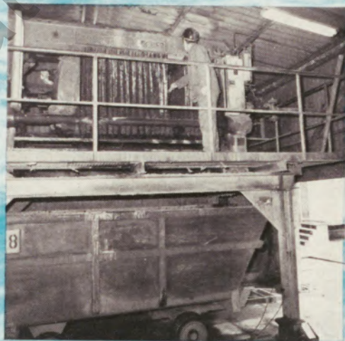
Bild 8 Unser Mitarbeiter Mustafa Atar an der Schlammpreßanlage
