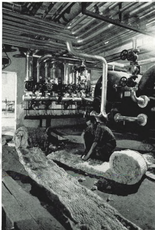
Ein Blick in den Keller des neuen Belegschaftshauses: Die Verteileranlage für das Warmwasser
