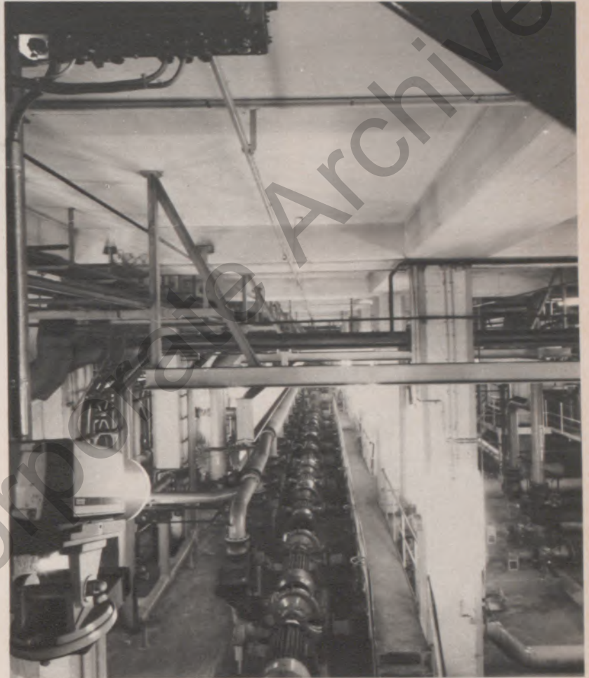
▼ Diese Pumpenbatterie führt den Walzgerüsten Kühlflüssigkeit zu
