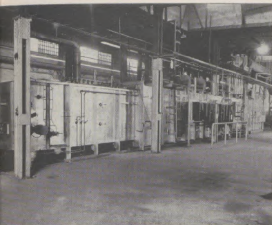
Gastemperofen - Bauart Bergische Stahl-Industrie und Indugas
