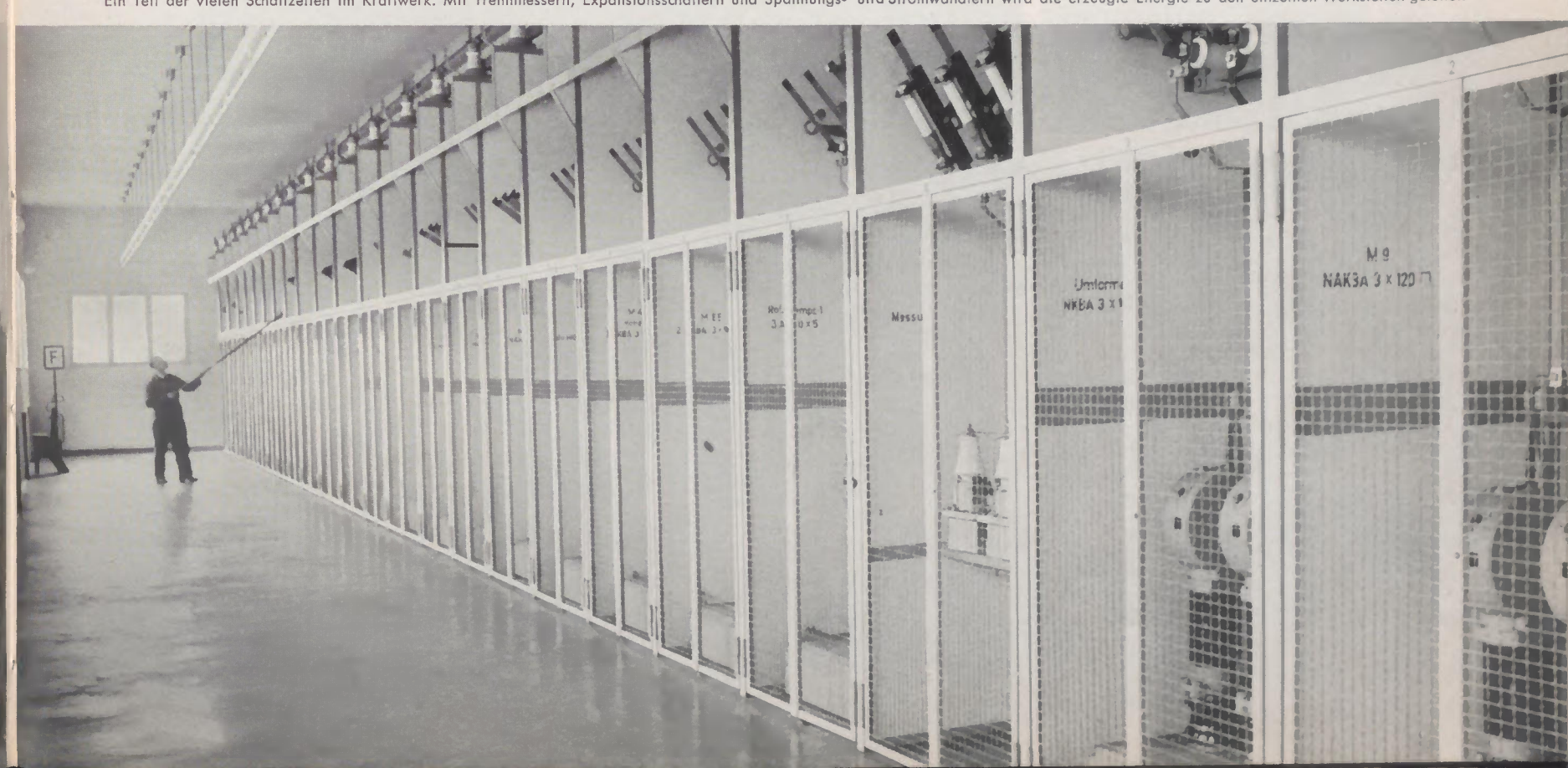
Ein Teil der vielen Schaltzellen im Kraftwerk. Mit Trennmessern, Expansionsschaltern und Spannungs- und Stromwandlern wird die erzeugte Energie zu den einzelnen Werksteilen geleitet.
