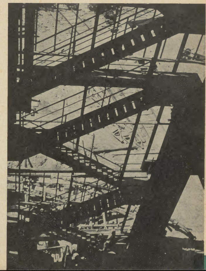
unten: Diese Treppen führen zu den Kranen und zu den maschinellen Anlagen auf dem Dach der 30 m hohen Halle. Gegenüber den üblichen steilen Leitern wurde mit dieser Neuerung eine erhöhte Unfallsicherheit erreicht.
