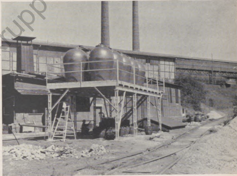
Die neue Säurespeicheranlage in Papenberg, über die bereits berichtet wurde
